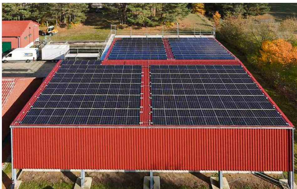
Auf der Kläranlage Mirow sorgt die großflächige Photovoltaikanlage seit Ende letzten Jahres zukünftig für Einsparpotenzial.
